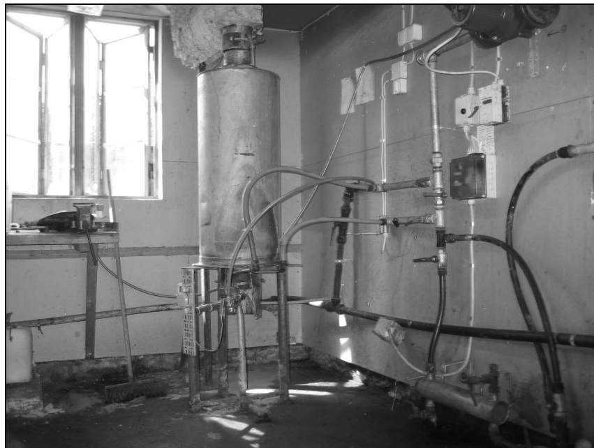
Figur 8. Rostfri värmepanna i pumprummet intill anläggningen.
